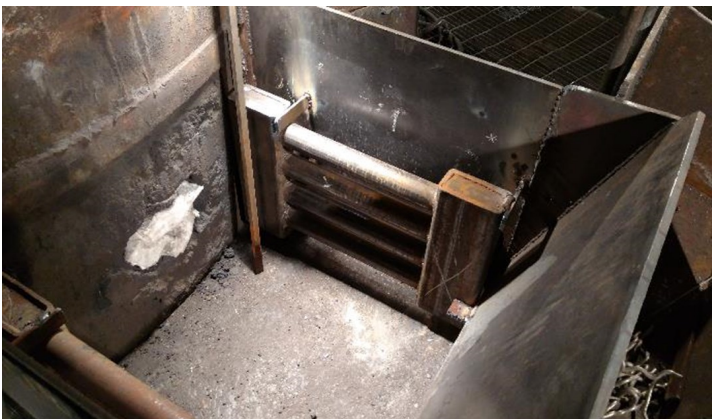
Slag Hole Cooling
